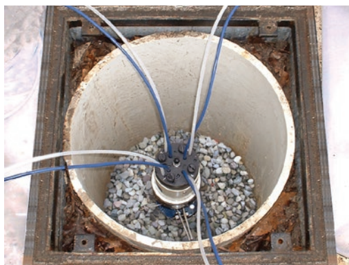
Figura 9-1 Tubería organizada alrededor del cabezal de pozo
